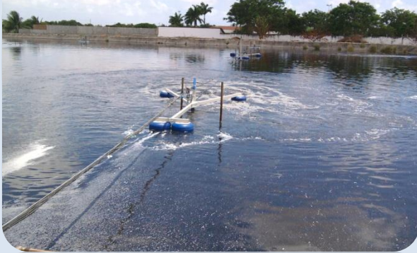
Lagoa Aerada Aeróbia
