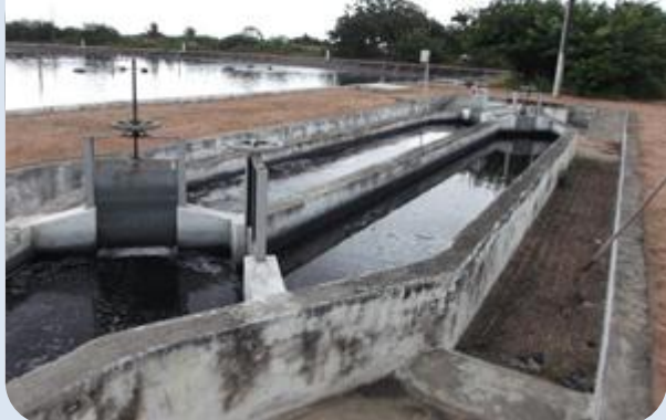
Tratamento Preliminar - Caixa de Areia
